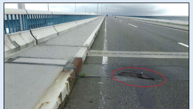
○舗装が破損した状況の写真
